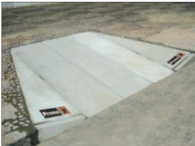
Figura 70 – Guia rebaixada para vaga reservada de estacionamento
